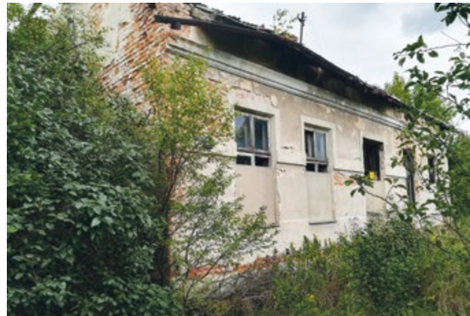
Spalony dom przy ul. Wolności. Fot. A. Krempa
